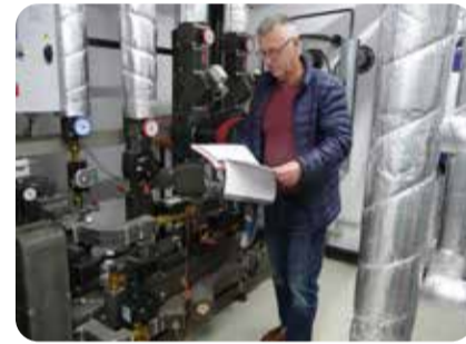
Michael Post, Meister Erzeugung/Heizwerke, bei der Kontrolle der Fernwärmekompaktstation nach Inbetriebnahme.
