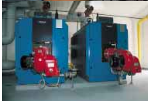
Schadstoffarmes Erdgas sorgt in den zwei Brennern für warmes Wasser
