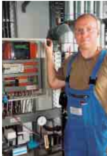
Monteur Falko Vieweg überprüft eine Schaltanlage im Blockheizkraftwerk
