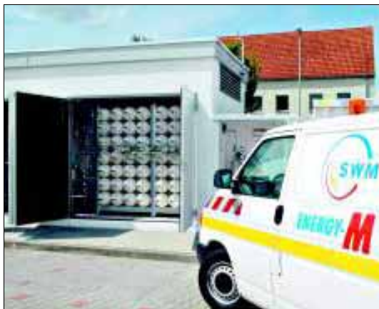
Ein Blick in das „technische Innenleben“ der Merseburger Erdgas-Tankstelle, die seit Juni in der Leipziger Straße 11 (STAR-Tankstelle) ständig geöffnet ist.
