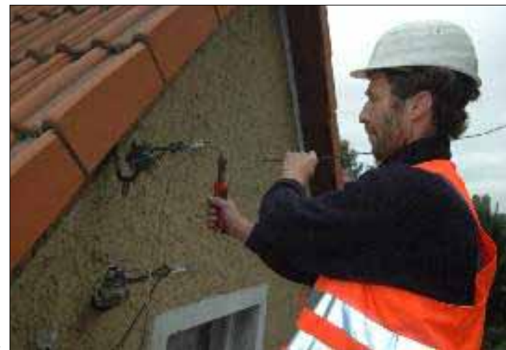
Der Monteur beim Abbau eines alten Freileitungshausanschlusses am Knapendorfer Weg. Mit insgesamt 15 Kabelhausanschlüssen haben die Stadtwerke Merseburg in diesem Bereich die Versorgungssicherheit ihrer Stromkunden erhöht.
